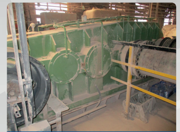
Im laufenden Betrieb
